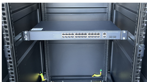
exemple d'un switch fixé à 2 équerres de rackage
